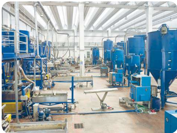
Reparto Produzione Caldara Plast - Sede Compound, Alzate Brianza (CO)
