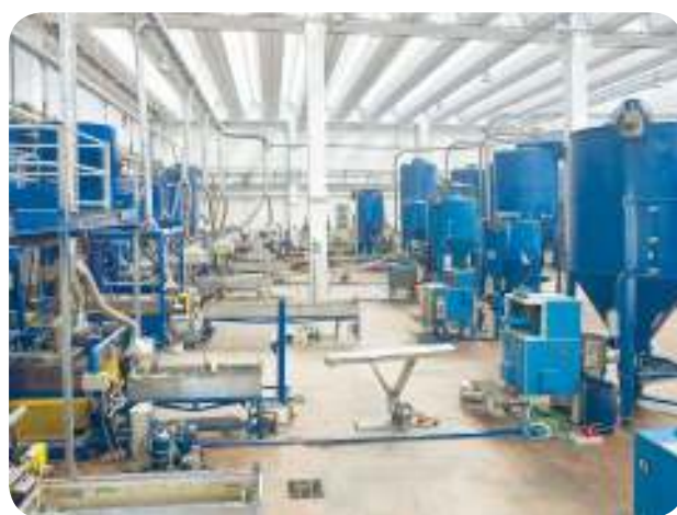
Reparto Produzione Caldara Plast - Sede Compound, Alzate Brianza (CO)
